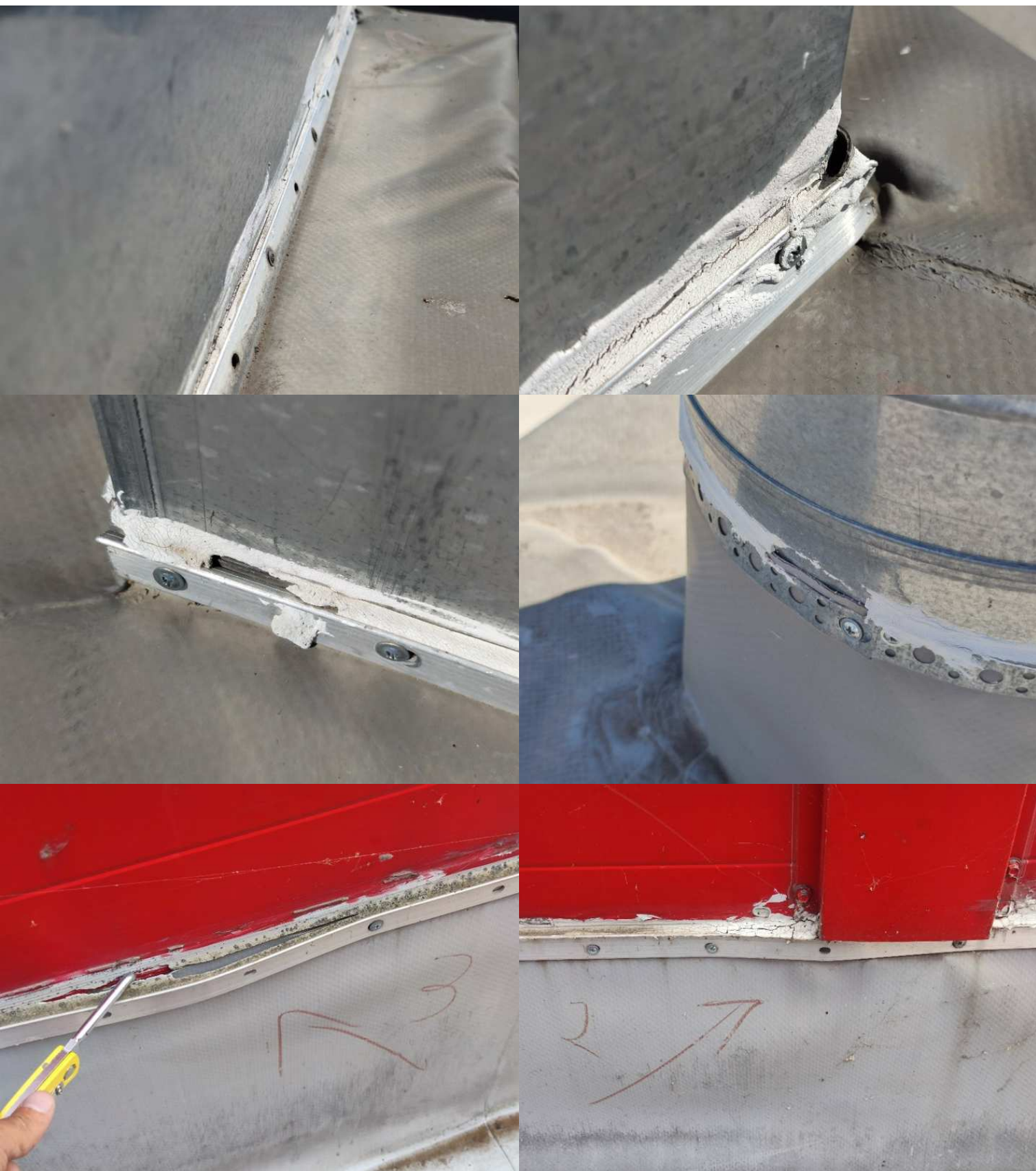
Нарушение герметизации вентиляционных установок
