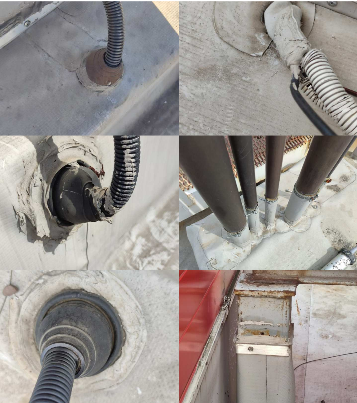
Дефекты герметизации примыканий из краевых реек и металлических хомутов с помощью ПУ герметика
