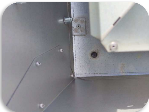
Нарушение герметизации вентиляционных установок
