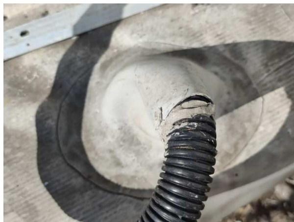
Фото 6. Г2. Проходной элемент (кабель в гофре): разрушение герметизации манжеты
