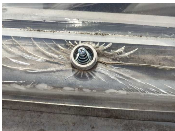
Фото 11. Г5. Зенитный фонарь: растрескивание купола вокруг точки крепления
