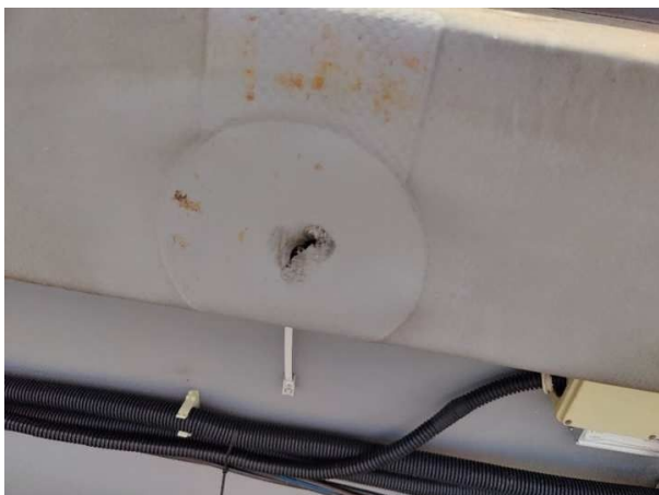
Фото 5. Г1. Сквозное отверстие в мембране на вертикальном участке примыкания
