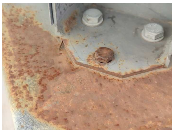
Фото 10. Г4. Опора вентиляционной установки: коррозия, негерметичный узел крепления
