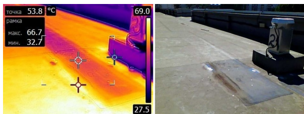
Фото 13. Г7. Термограмма и фото: участок скопления влаги под ковром у кровельной дорожки (дефект сварного шва дорожки; устранён)
