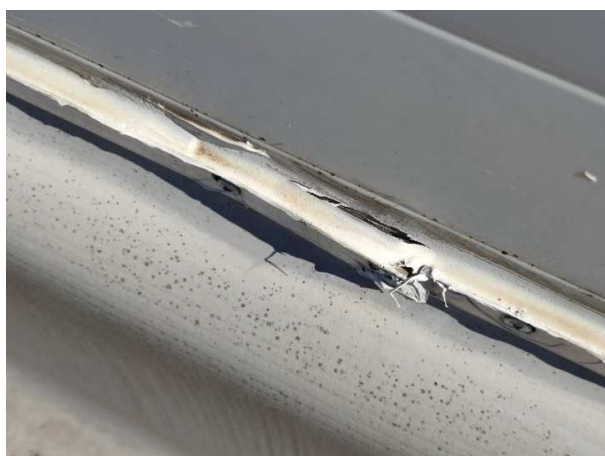
Фото 9. Г3. Отслоение ПУ-герметика по краевой рейке
