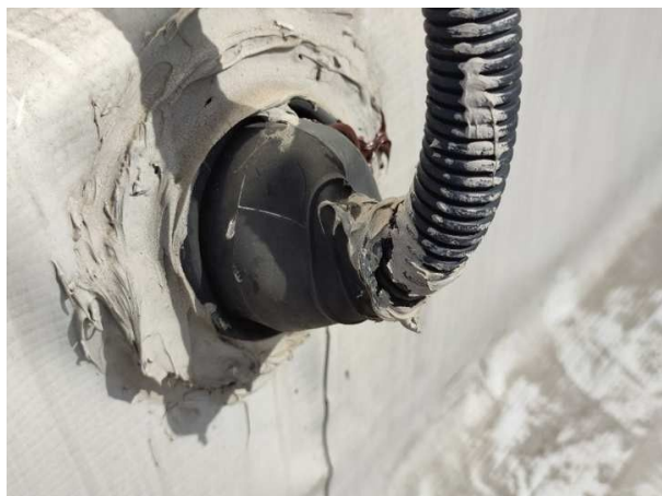
Фото 7. Г2. Проходной элемент: негерметичный ввод кабеля, растрескавшийся герметик
