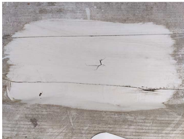
Фото 2. Г1. Разрыв (трещина) ПВХ-мембраны, участок зачищен под ремонт
