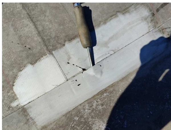
Фото 4. Г1. Дефект сварного шва: пробник свободно входит в нахлест
