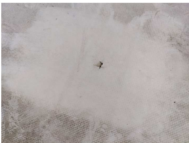
Фото 3. Г1. Точечный прокол мембраны в поле кровли
