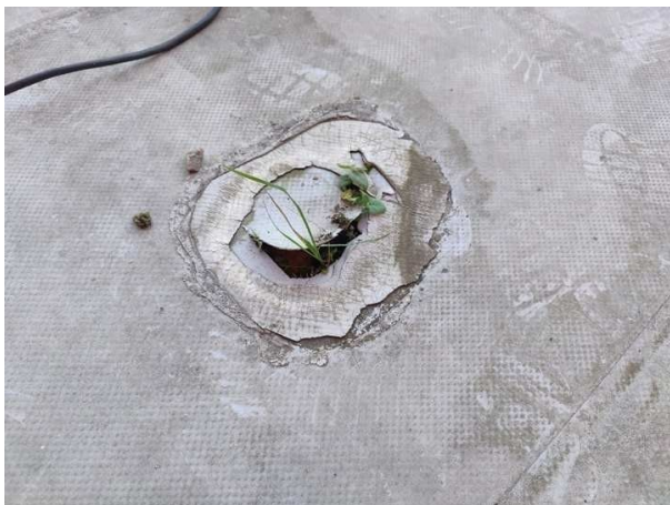
Фото 1. Г1. Сквозное механическое повреждение мембраны; в отверстия проросла растительность
