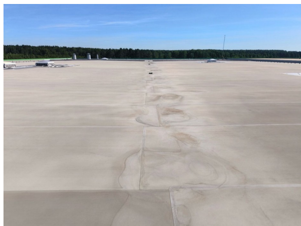
Фото 18. Ендова без контруклонов: следы застоя воды (Дефект № 8)
