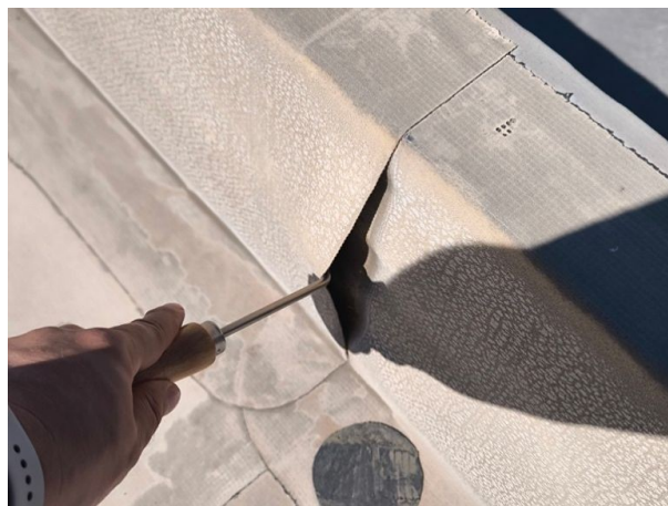
Фото 14. Раскрытие шва полотен с образованием щели (Дефект № 5)
