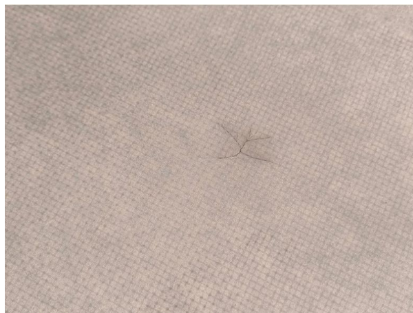
Фото 2. Сквозь истончённый слой видна армирующая сетка; звездообразная трещина (Дефект № 1)
