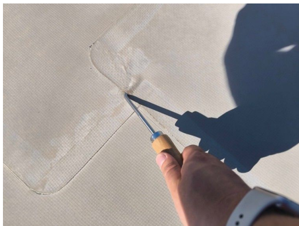
Фото 13. Проверка шва щупом: непровар/расслоение шва (Дефект № 5)
