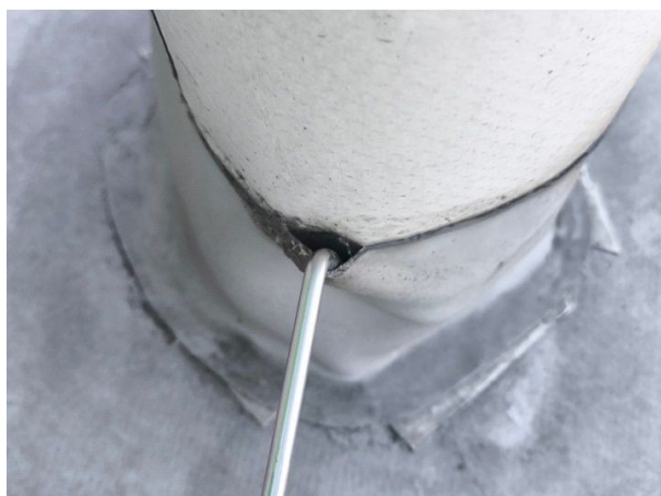
Фото 17. Проходка без прижимного хомута: зазор между мембраной и трубой (Дефект № 7)
