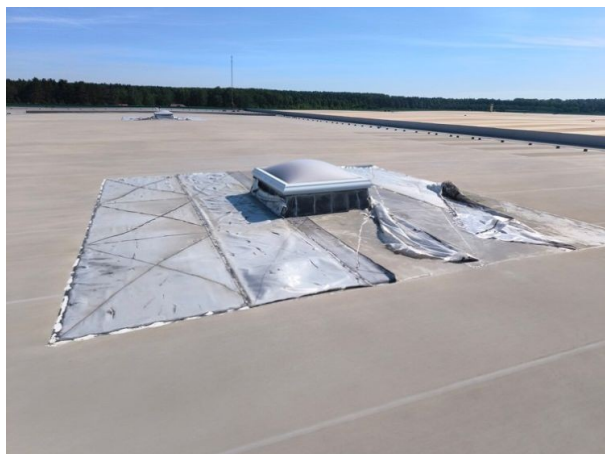
Фото 19. Противопожарная рассечка вокруг люка: материал отслаивается (Дефект № 9)
