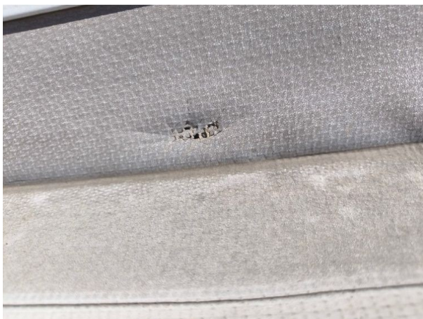
Фото 1. Истончение мембраны у шва: верхний слой утрачен, армирующая сетка обнажена, выкрашивание (Дефект № 1)
