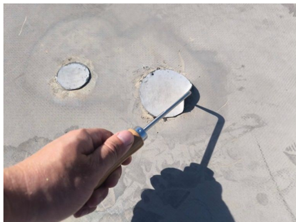
Фото 16. Ранее установленная латка отслаивается от основания (Дефект № 6)
