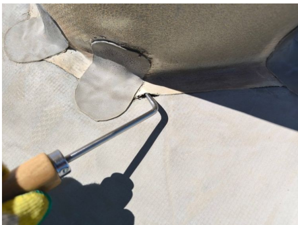
Фото 5. Примыкание: латки и отслоение мембраны, проверка щупом (Дефект № 3)
