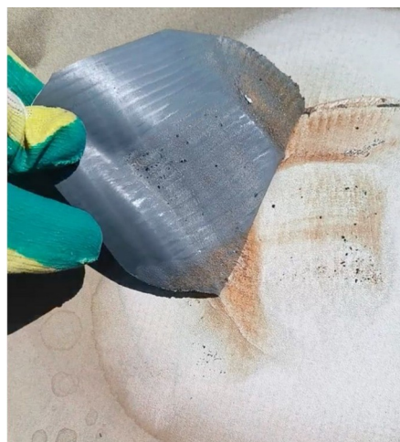
Фото 12. Пробная латка снимается рукой — сварного соединения нет (Дефект № 4)
