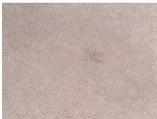
Фото 4. Звездообразная трещина на полотне — потеря эластичности (Дефект № 2)
