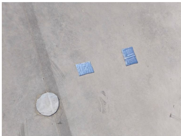
Фото 15. Клеящиеся ремонтные латки на полотне (Дефект № 6)
