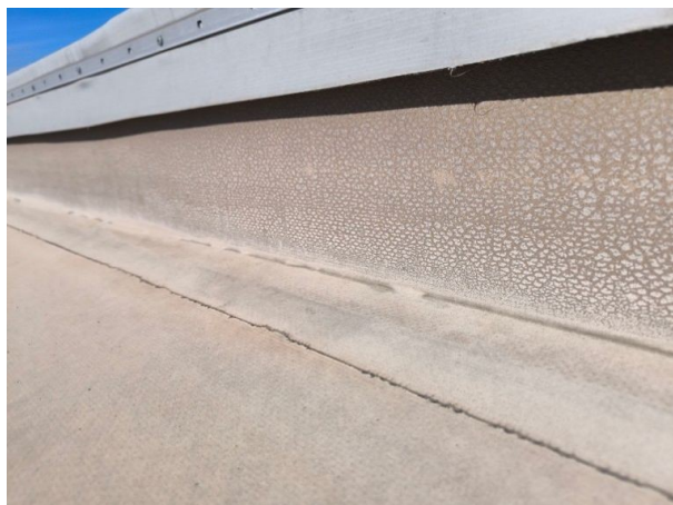
Фото 7. Вертикальное примыкание к парапету: сетка мелких трещин по всей поверхности (Дефект № 3)
