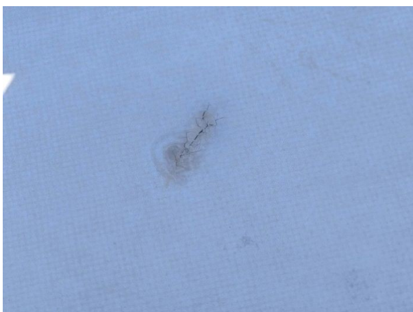
Фото 3. Ломаная трещина с ответвлениями — признак хрупкости мембраны (Дефект № 2)
