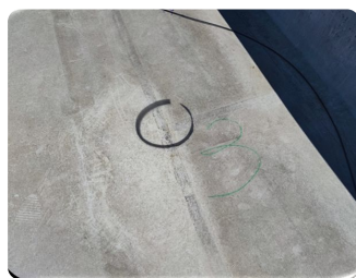
2. Дефект сварного шва
