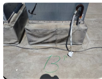
4. Примыкание: нарушена герметизация
