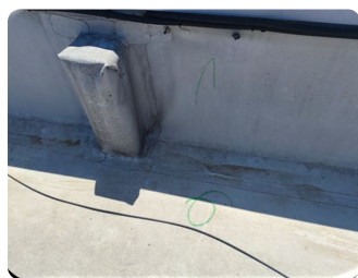
1. Механическое повреждение ковра
